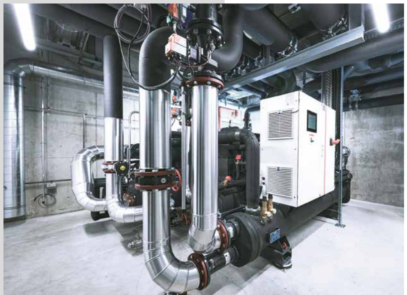
Die Hall AG nutzt Großwärmepumpen, um die Effizienz des Biomasseheizkraftwerks zu steigern
